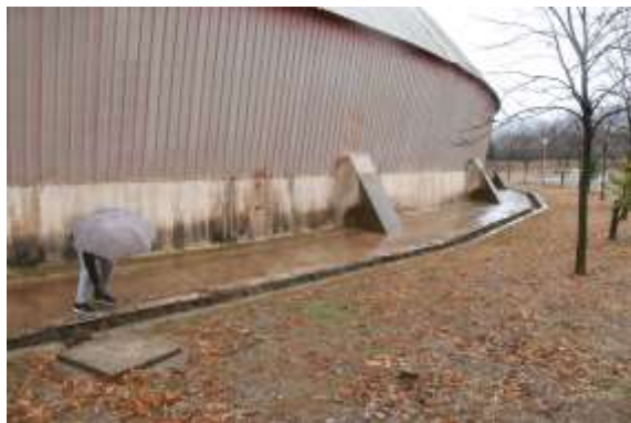
均化库堆场周边砖砌排水明沟
